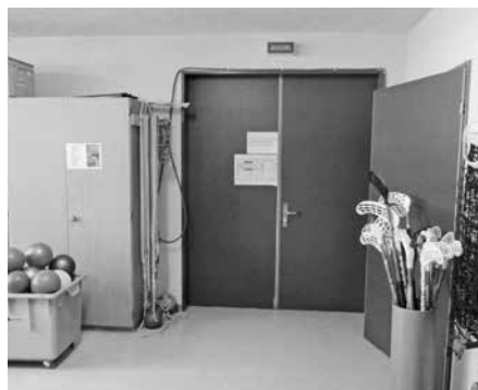
Vor der Sanierung: Verbindungstüre nicht fluchtwegkonform
