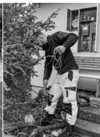
Einzug des Kabels in den Hausanschluss
